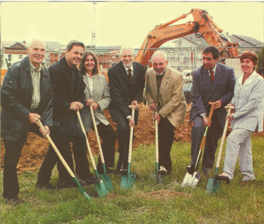
Gemeinsamer Spatenstich für das „Haus der Kirche und der Diakonie“ (von links): Egon Roth (Diakonie Idstein), Ditmar Joest (KWB-Geschäftsführer), Claudia Kohlhaas (RDW Rheingau-Taunus), Bürgermeister Gerkard Krum, Helmut Schumann (RDW-Verwaltungsrat), Wolfgang Wartenberg (RDW Rheingau-Taunus) und Dekanin Heinke Geiter. Foto: wita/Iris Schmitz
